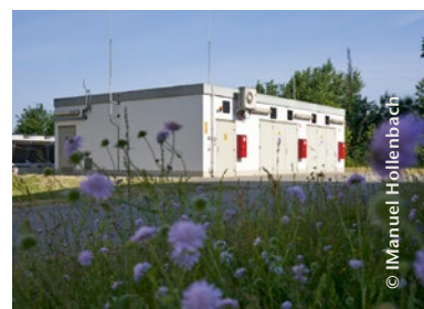
Einspeiseanlage für Biogas in Osterhofen.
