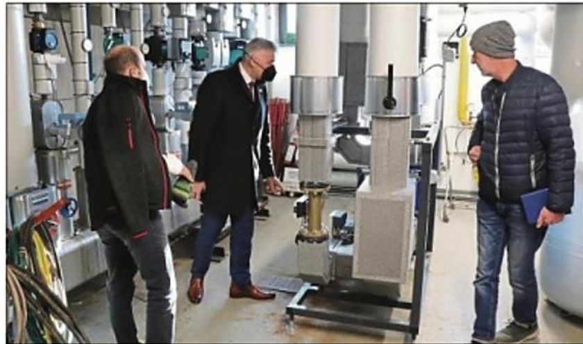
Bürgermeister Josef Dollinger (M.) begutachtete am Donnerstag die Wärmeübergabestation am Schulzentrum Nord.
